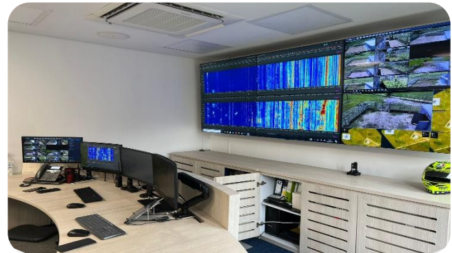
Fig 6. Command Center: Centro de vigilancia y control integrado.
