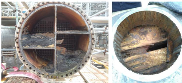
Figura 3. Falla de 2020 de los E-11, ocasionada por patrón de ensuciamiento acelerado y corrosión ácida bajo depósitos
