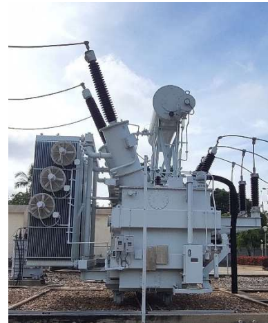
Fig 5. Transformador de potencia renovado con índice de salud IH=1.
