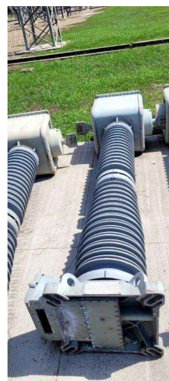
Fig 7. Transformador de corriente desmontado.
