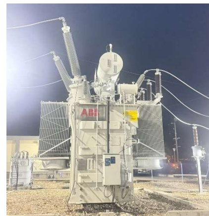
Fig 6. Nuevo Transformador de potencia en
