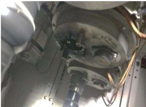
Fig 5. Evidencia estado de campana en Celda
