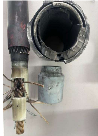
Fig 7. Estado terminal cable Celda 34,5kV
