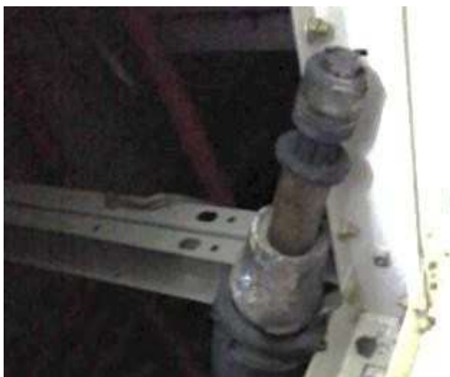
Fig 6. Estado cable de potencia en Celda
