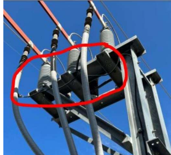
Fig 3. Aterrizaje extremo Transformador (Pórtico)
