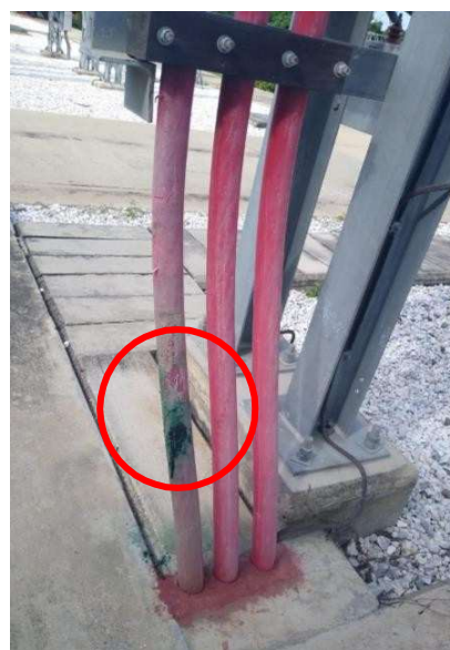
Fig 1. Fisura presentada en cable de potencia XLPE
