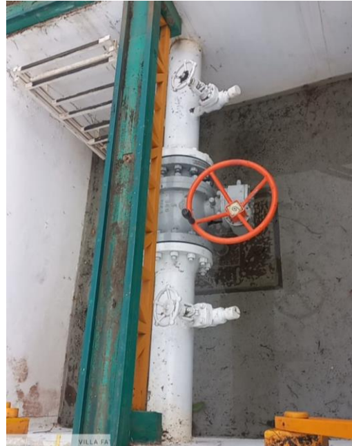
Fig 5. Caja válvula 116 – Red Acero Cali.
