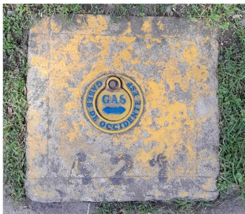
Fig 3. Poliválvula que requiere pintura.
