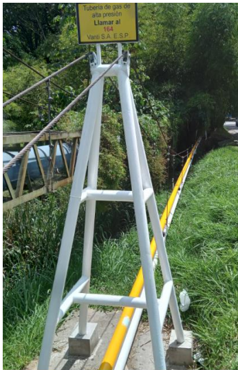
Fig. 5 Cruce Tipo Torre
