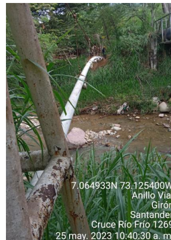
Fig. 10 Deformación Tubería y estado de torres
