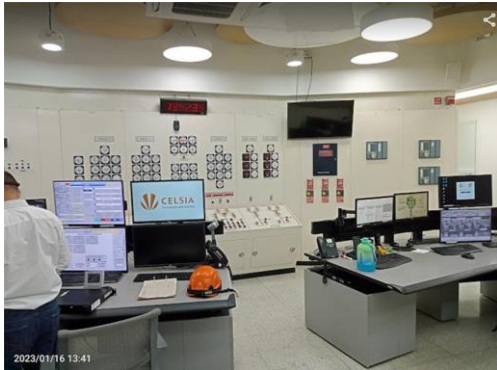
Fig. 1 Sala de Control CH Alto Anchicayá
