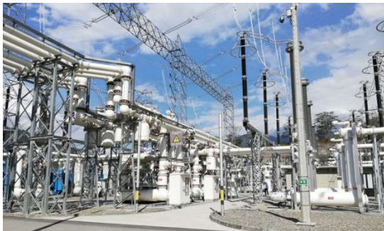
Fig b. Subestación eléctrica 500 kV tipo GIS.
