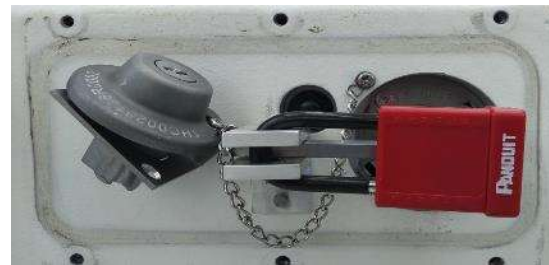
Fig 5. Bloqueo mecánico Subestación GIS
