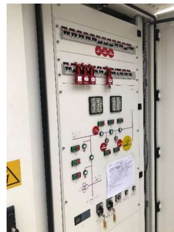
Fig 4. Bloqueo eléctrico LCC Subestación GIS
