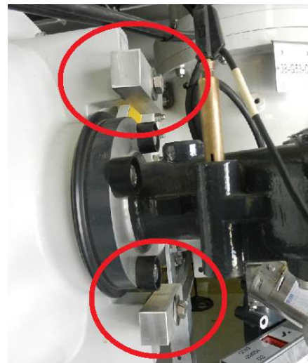
Fig a. Link de conexión de una subestación GIS fabricante ALSTOM.
