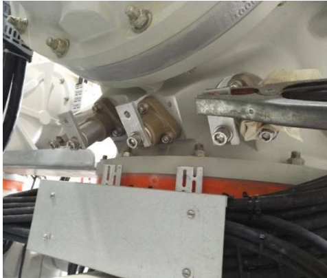
Fig b. Link de conexión de una subestación GIS fabricante HITACHI.
