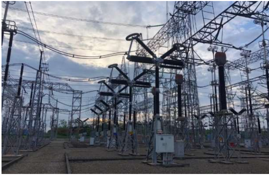
Fig a. Subestación eléctrica 500 kV tipo AIS
