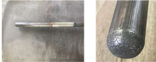
Fig 6. Estado del contacto de sacrificio del interruptor 2L170 en San Carlos 230 kV.
