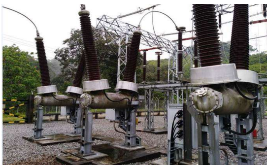
Fig 1. Interruptores de San Carlos 230kV SIEMENS 3AP1DT
