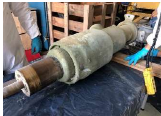
Fig 5. Evidencia de daños en el sistema de contactos del interruptor 2L170 en San Carlos 230 kV.
