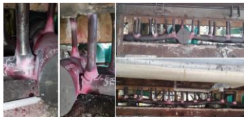
Figura. 6 prueba de líquidos penetrantes que ponen al descubierto las grietas presentes en los cabezales de salida.
