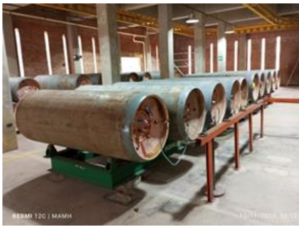
Figura 2 Cilindros de cloro PTAP Wiesner
