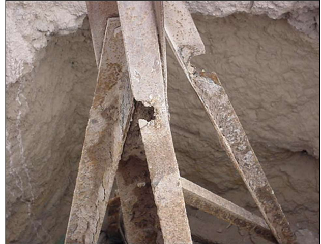
Foto 6. Corrosión por suelos en fundación metálica de torre de transmisión de energía auto soportada.
