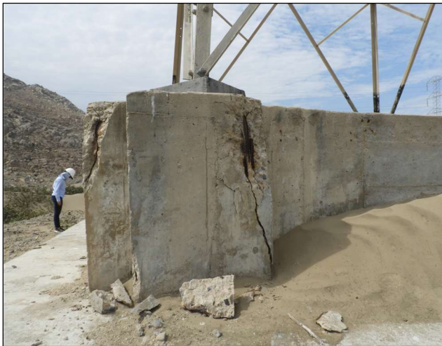
Foto 5. Corrosión en concreto de una fundación de torre de transmisión de energía auto soportada.
