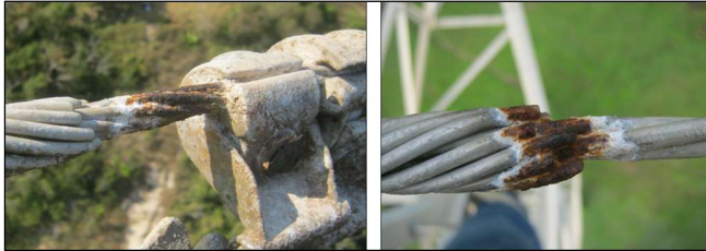
Fig. 6. Corrosión multi factores en una grapa de anclaje de un amortiguados del tipo “Stock bridge” y en el blindaje en un cable de apantallamiento.
