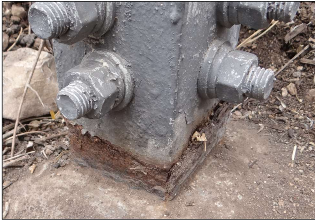
Foto 4. Corrosión por aireación diferencial en pata de torre de transmisión de energía auto soportada.
