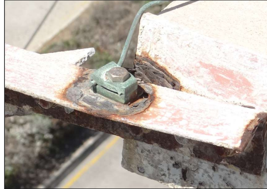
Foto 2. Corrosión galvánica entre una grapa de puesta a tierra de cobre con un perfil de acero estructural.
