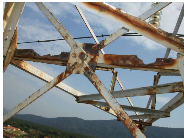
Foto 1. Corrosión atmosférica en elementos estructurales de una torre de transmisión de energía.
