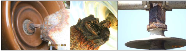
Fig. 2. Corrosión atmosférica en partes metálicas de aisladores de porcelana, vidrio y polimérico.
