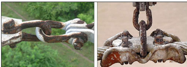
Fig. 4. Corrosión atmosférica en diferentes tipos de herrajes de una línea de transmisión de energía.
