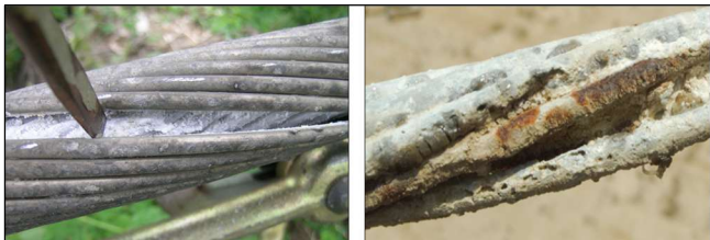
Fig. 3. Corrosión atmosférica en un cable conductor de fase y en un cable de apantallamiento.
