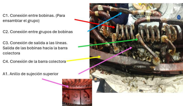
Figura 8. Condición de aislamiento y partes de conexión de las bobinas.
