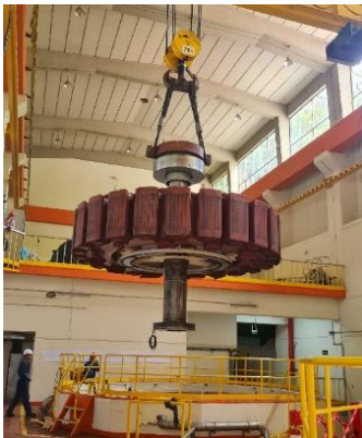
Figura 11. Rotor del generador de la unidad 3 de Prado.
