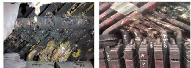
Figura 7. Bobinas superiores averiadas del estator.
