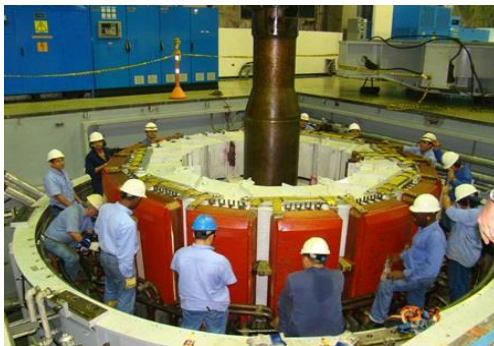
Figura 3. Unidad 3 de la central hidroeléctrica Alto Anchicayá.
