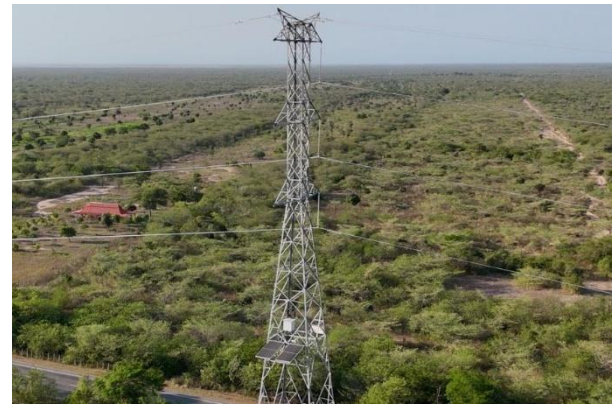
Fig 2. Nodo Secundario ubicado en la Torre RIMA34. Se pueden apreciar en el cuerpo de la torre los paneles solares que proveen de energía a los equipos del gabinete y a la antena de transmisión de radio.
