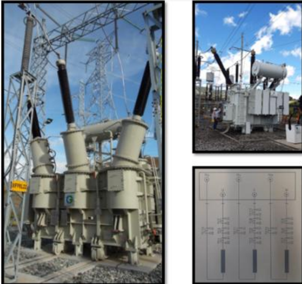
Fig. 7. Reactores trifásicos Reactores trifásicos 25MVAr - 230kV
