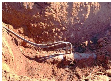
Imagen 3. TAP Ilícito en Ducto
