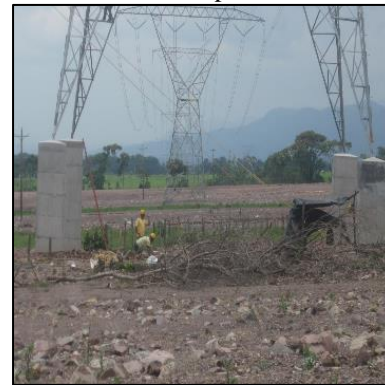
Fig. 10. Torre C – Construcción de pedestales y protección con pedestales en “L” Fuente: Propia, 2024
