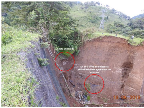
Fig. 10. Socavación – Zona 3 Fuente: Propia, 2021
