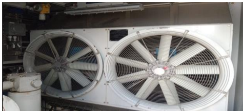
Fig. 12. Moto ventiladores unidad de compresor.
