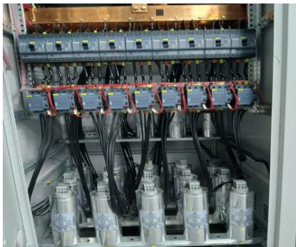
Higo. 1. Banco de condensadores, contactores fijos y variables.
