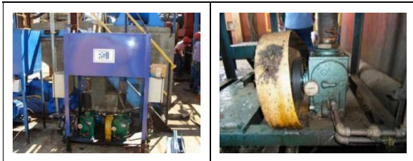
Fig. 38/39 – Sistema de lubrificação centralizado a óleo em moendas
