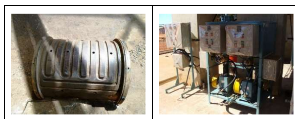
Fig. 53/54 – Camisa de refrigeração de mancais e sistema de recalque
