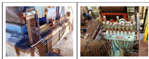
Fig. 47/48 – Distribuidor e tubulações de óleo lubrificante utilizados na lubrificação de mancais de moenda
