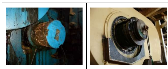
Fig. 34/35 – Lubrificação por circulação com perda total
