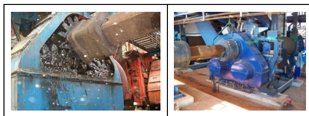
Fig. 18/19 – A vedação dos envelopes tem sido bastante aprimorada de forma a evitar a contaminação do óleo lubrificante por pó, água e bagaço
