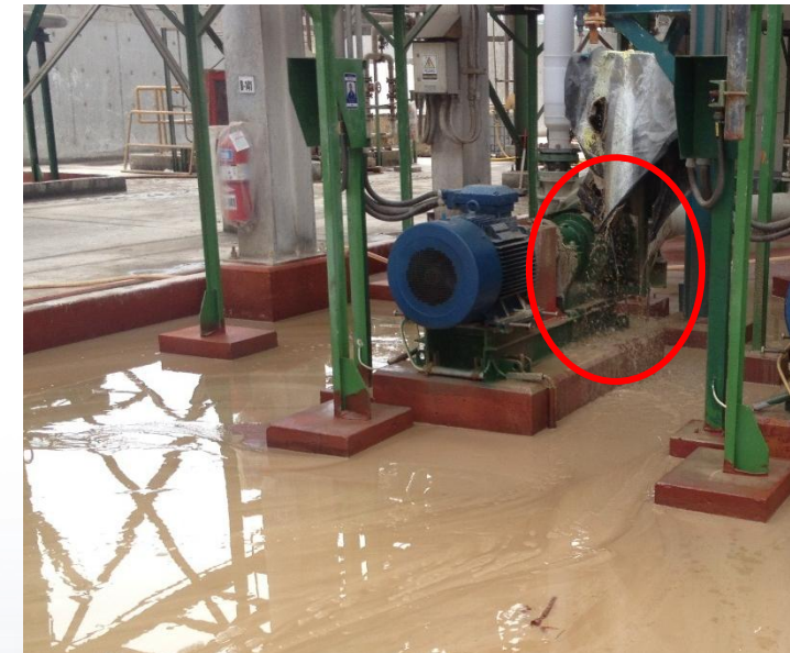
Fuga de producto por un sello en mal estado
