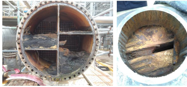
Figura 1. Falla de 2020 de los E-11, ocasionada por patrón de ensuciamiento acelerado y corrosión ácida bajo depósitos
